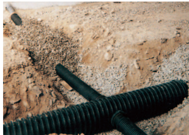
▲ トンネルセンタードレン
