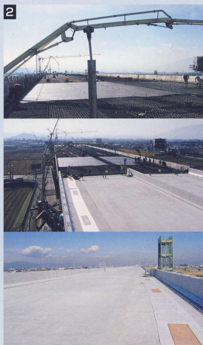
2 国土省近畿地方整備局・ 大和御所道満田橋高架工事／ 床版ひび割れ対策
