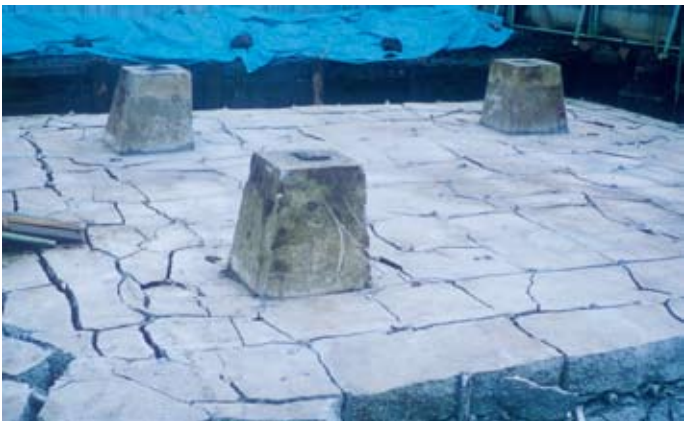
仮設基礎破碎 (スパイラルシース管理め込み φ45mm 孔間隔450mm)
